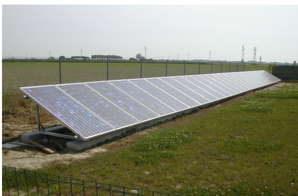
I pannelli fotovoltaici
