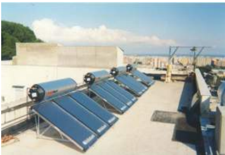
Tipica installazione per il riscaldamento di più unità residenziali
